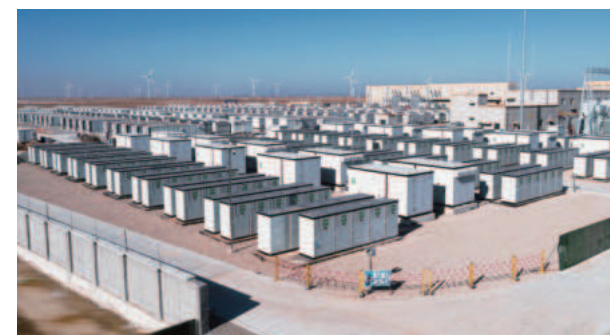
东营津辉100MW/200MWh独立共享储能项目
