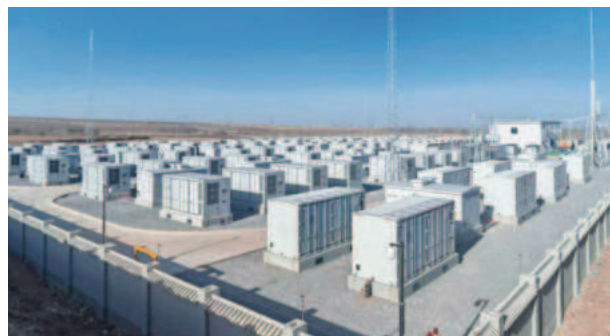
宁夏瀚骏150MW/600MWh储能项目
