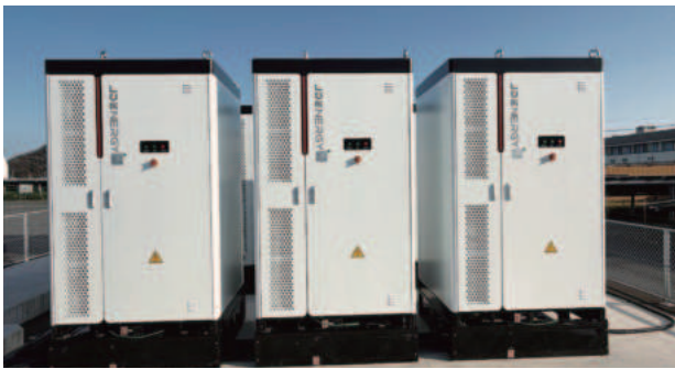
日本1.29MW/2.508MWh用户侧储能项目 ——日本首个工商业储能项目、优化负荷、降本减碳
