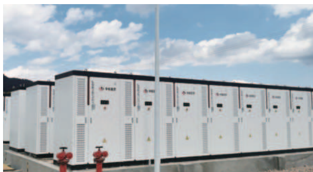
中核临翔200MW/400MWh储能电站
