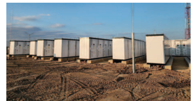
匈牙利MVM国家电网11MW/22MWh储能项目
