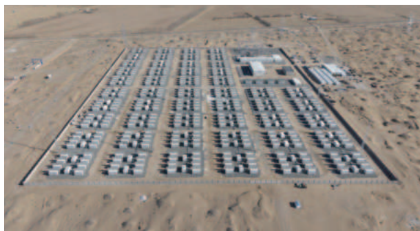
内蒙古磴口 500MW/2000MWh 储能电站
