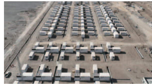
甘肃酒泉450MW/900MWh储能电站
