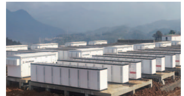
震东100MW/200MWh电化学储能项目
